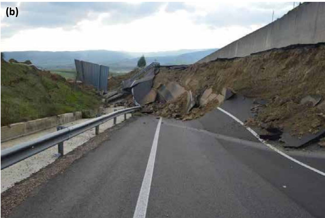
Figura 12: a) Foto aerea, scattata il giorno 4 dicembre 2013, che evidenzia una grande frattura (frecche rosse più grandi), con un dislocamento di circa 8 – 10 m in altezza; b) Danneggiamento della nuova arteria di accesso al paese.
